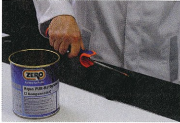
Basisarbeits: Dunkler Untergrund wird mit der Rolle aufgetragen und verstärkt den Glimmer-Effekt Fotos: Zero-Lack
